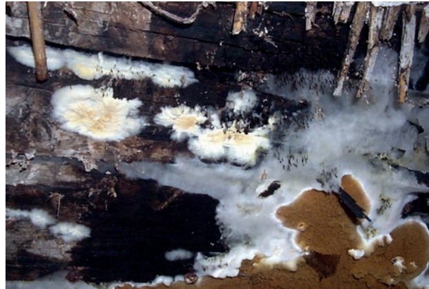
Källarsvamp och hussvamp.
